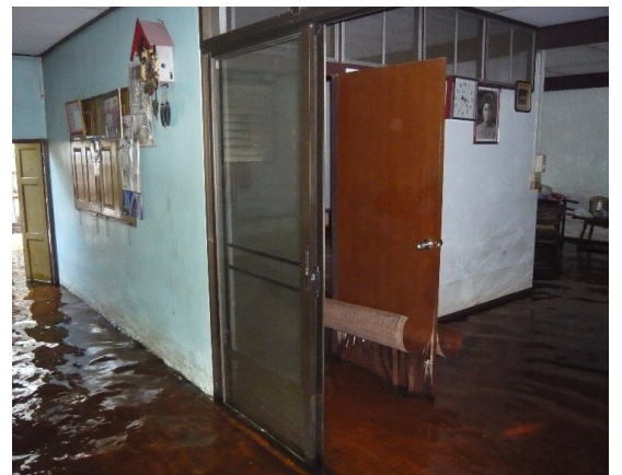
รูปที่ 6 ลักษณะของบานประตูหลังถูกน้ำท่วม
