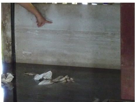
รูปที่ 2 สภาพของคราบน้ำและเชื้อราขึ้นบนผนังหลังน้ำลด
